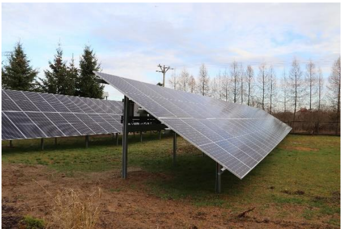
Fotowoltaika na potrzeby oczyszczalni
